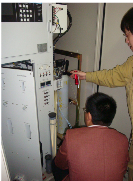
图4 中国某火力发电厂脱硝设备出口处的 \text{NH}_3 逃逸率监测装置
